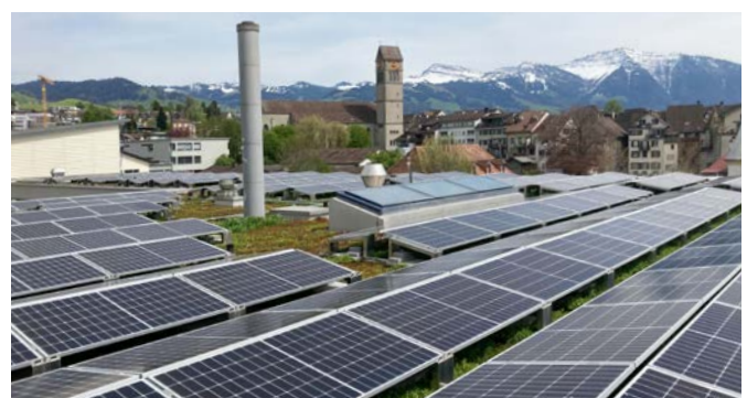
Abb. 6: PV-Anlage auf OSZ Haslen
